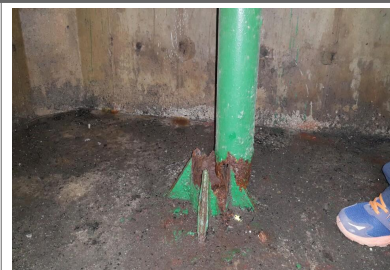
#19 철재계단 노후/지지대 파손
