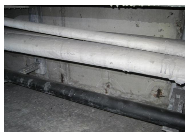
오금로 상수,통신구 철근노출
